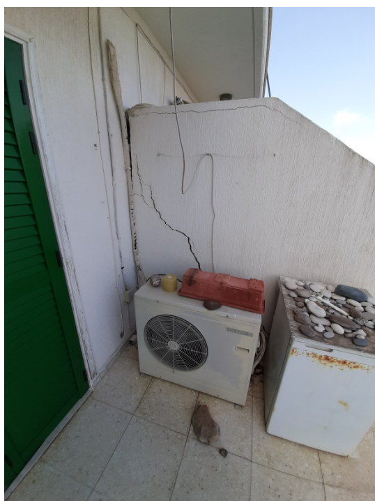
Εικόνα 47. Αποψη ρωγμών σε δομικά στοιχεία του κτιρίου A της ανωτέρω εικόνας.
